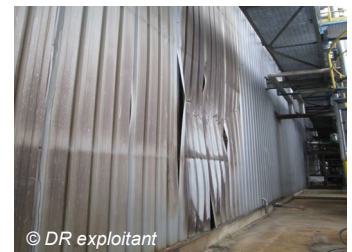
Dégât matériel visible à l'extérieur de l'atelier
