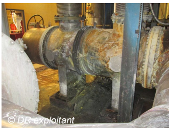
Echangeur de chaleur
