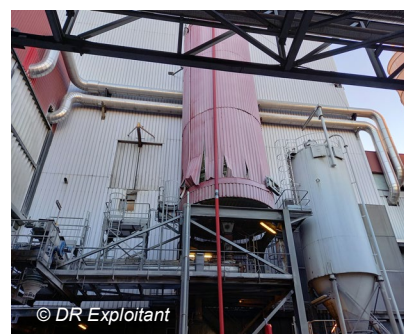
Silo de REFIO endommagé
