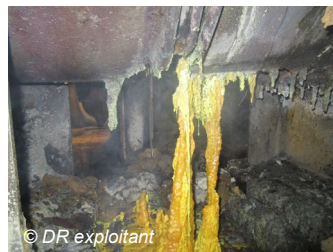
Fuite de Soufre au niveau de l'échangeur de chaleur
