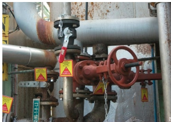
Vanne cadennassable ouverte par erreur.
