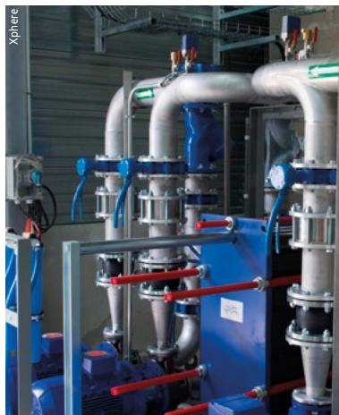
Un actionneur permet par exemple le démarrage d'une pompe, la fermeture ou l'ouverture d'une vanne.
