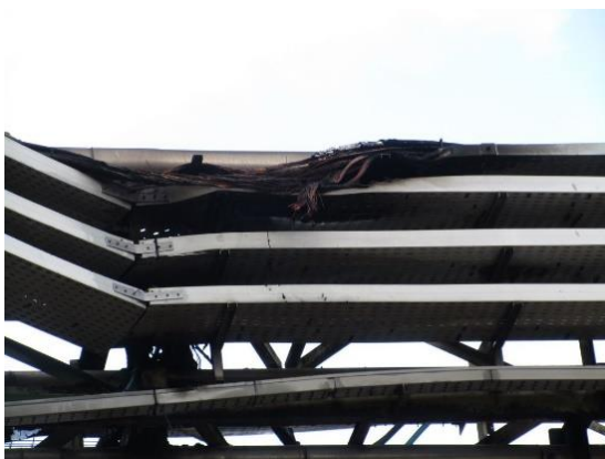
Figure 9 : ARIA 54499 : incendie de câbles électriques alimentant une électrovanne de sectionnement d'une tuyauterie d'ammoniac - ©DREAL
