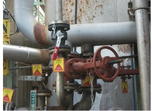
Figure 7: ARIA 44070 : Vanne cadenassable ouverte par erreur - ©Exploitant
