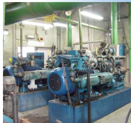
Figure 5 : compresseurs sur un site chimique - ©DRIRE
