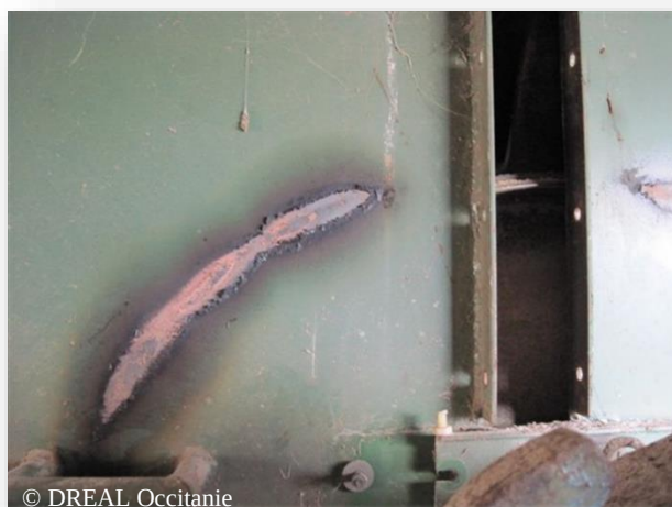
Trace d'échauffement sur carter d'élévateur – ARIA 36292
