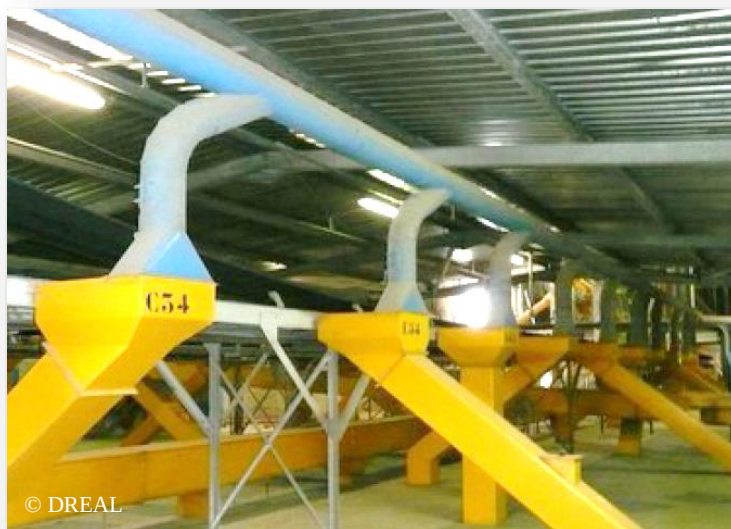
Aspiration de poussières centralisée sur un convoyeur
