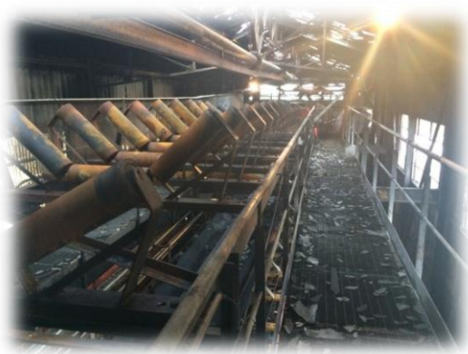
Bande transporteuse incendiée (© Exploitant)
