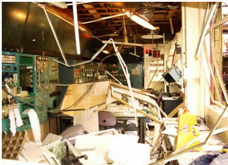
La salle de contrôle
