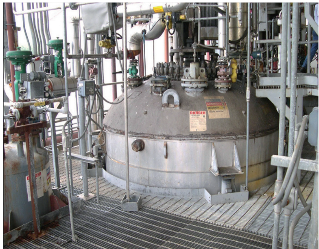
Réacteur dans une usine chimique française moderne : son chargement et la surveillance sont pilotés à distance depuis une salle de contrôle
