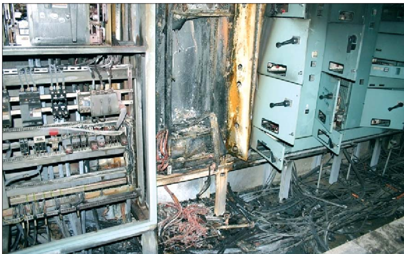
© DR Le réseau électrique de l'entreprise est un centre névralgique
