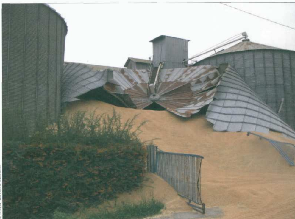
Rupture d'une cellule métallique à Pezens le 9 octobre 2006 (Aude)
