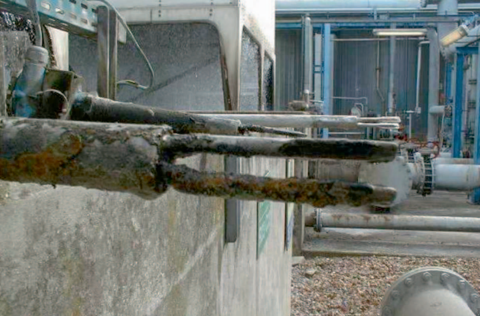
▲ Sondes de niveaux à lames vibrantes encrassées.
