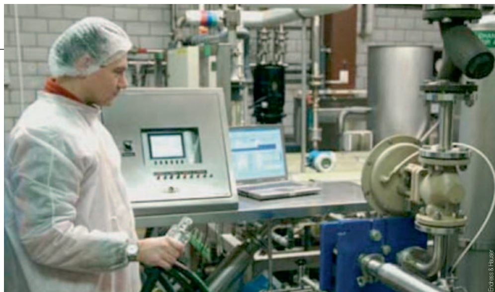
▲ Banc d'étalonnage en ligne de débitmètres.
