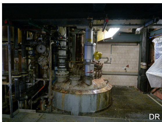
Fig. 1: Vue du réacteur après l'accident
