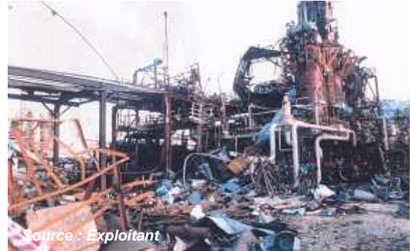
Figure 5 - Vue sur la section cryogénique
