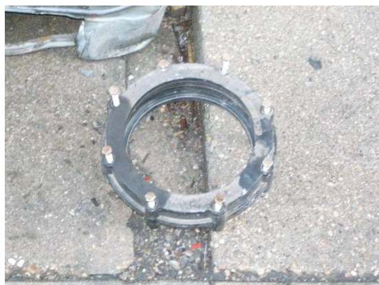
Figure 5 : Bride projetée à l'extérieur du bâtiment (source : exploitant)
