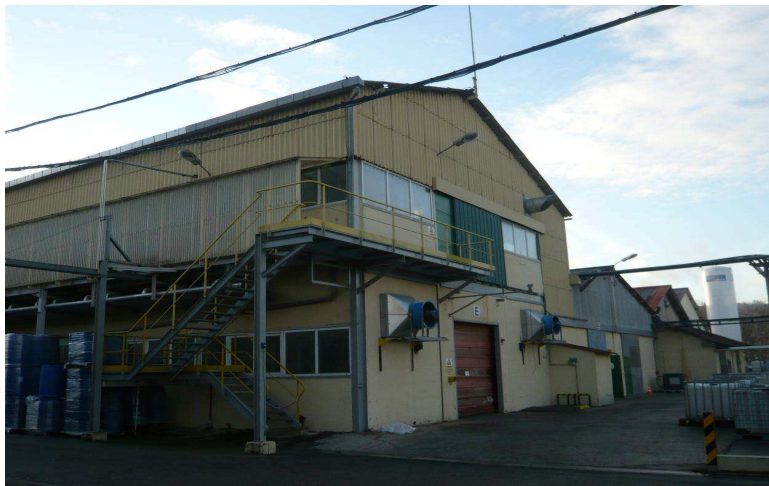
Figure 2 : Vue de l'unité accidentée (source : exploitant)
