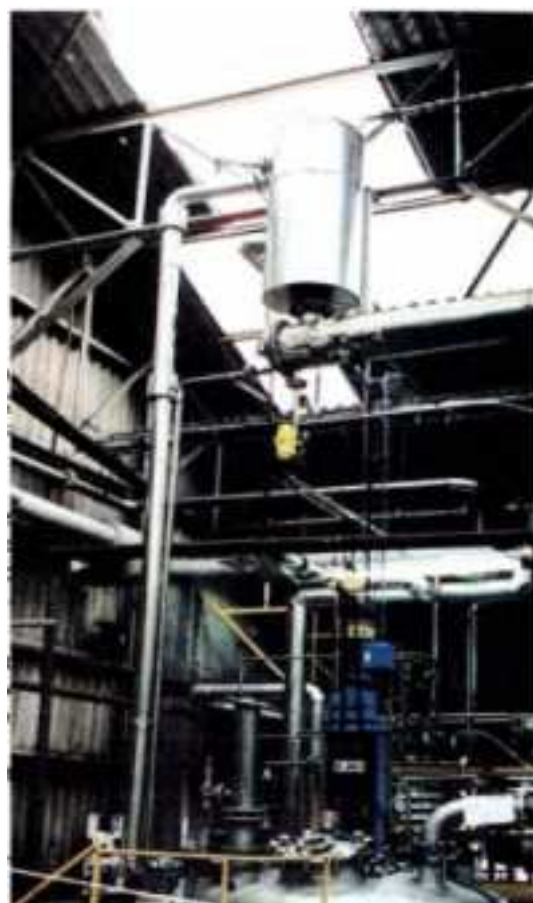
Dégâts en toiture – Source : DRIRE Auvergne
