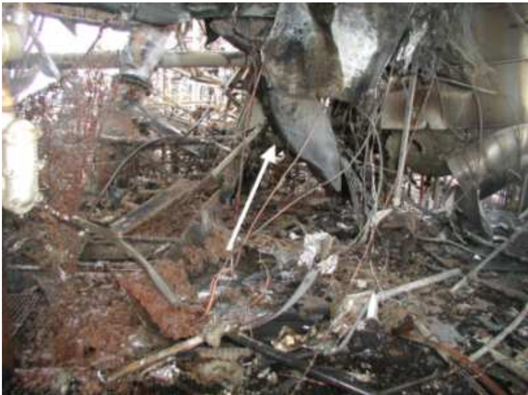
Fig. 3 – réservoir D 528/2 : 1 ère explosion
