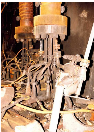
Détail du réacteur endommagé
