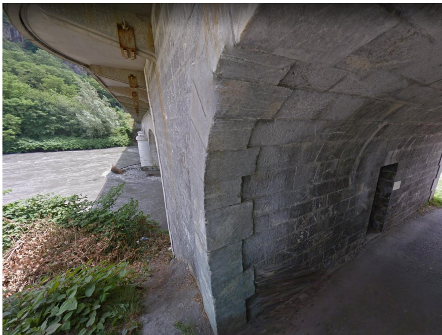
Entrée du local technique squatté (vue du parking : V1)
