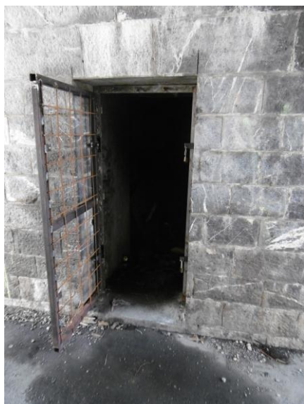
Porte d'entrée du local technique rajoutée après l'accident (© DREAL ARA)
