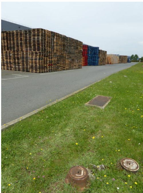
Présence d'organes de sectionnement du réseau de gaz naturel non loin de l'ilot incendié (source : BARPI)
