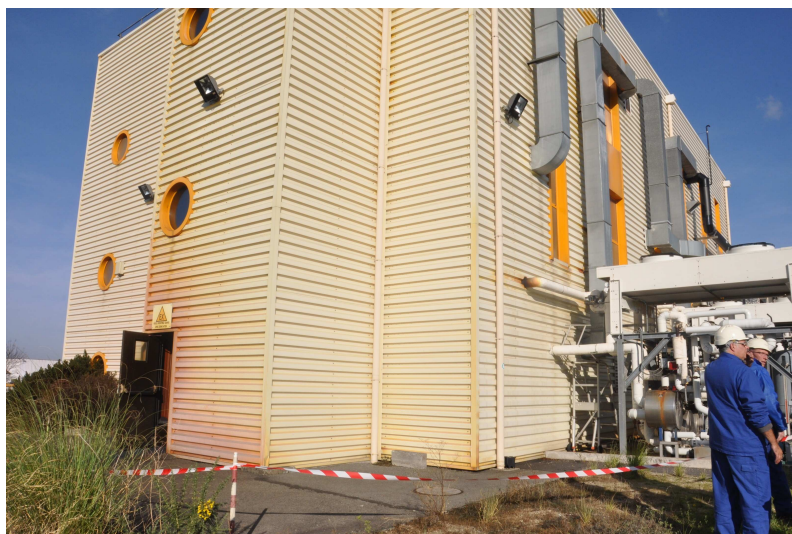
Traces de dépôt rouge sur le bâtiment B45 – Source DREAL Bretagne
