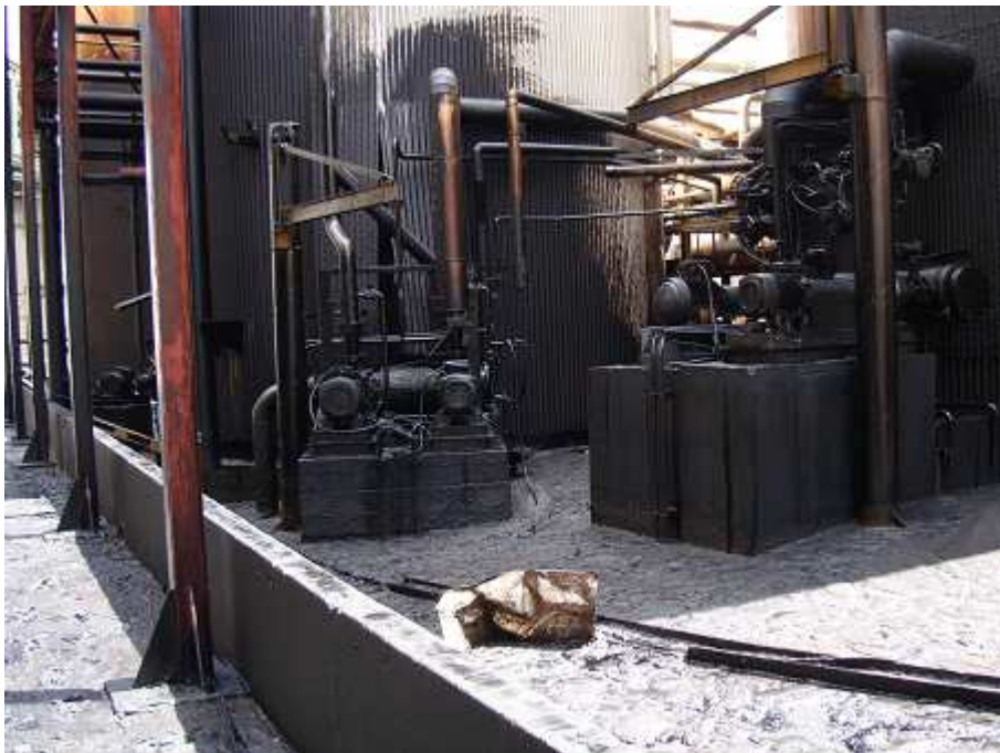
Muret de la rétention de la cuve TB7 - Source : DREAL Limousin
