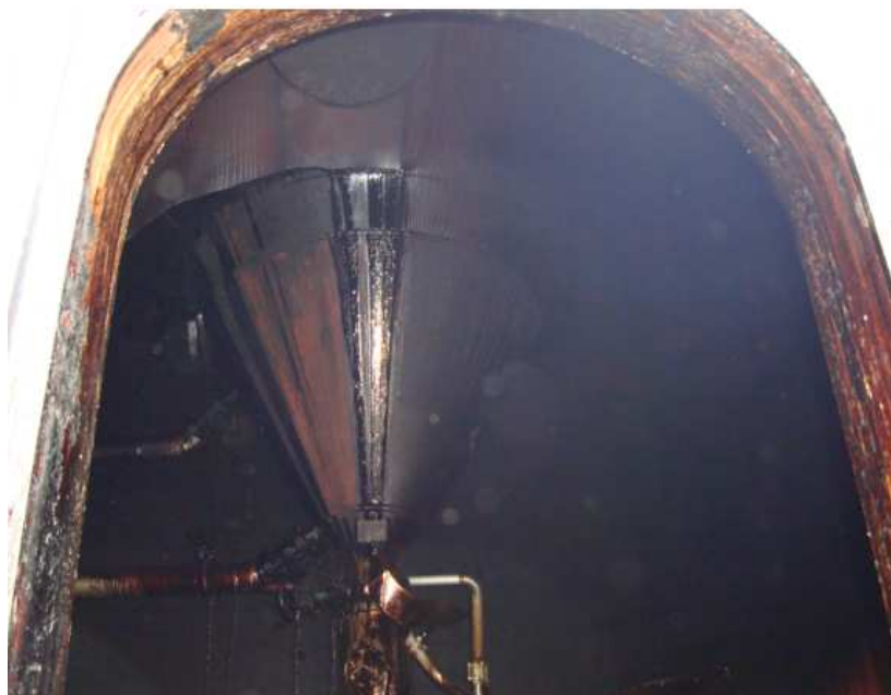
Fond conique de la cuve TB7 depuis l'ouverture de sa jupe - Source : DREAL Limousin
