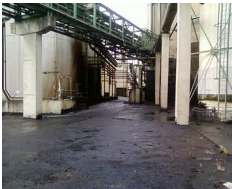
Etat des installations après l'accident - Source : SDIS
