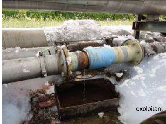
Compensateur de dilatation endommagé
