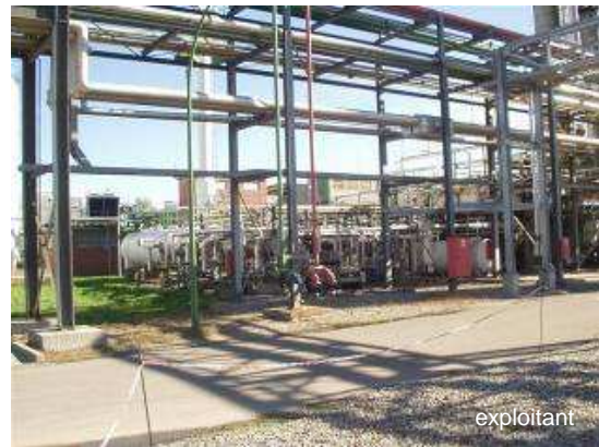
Rack de tuyauteries
