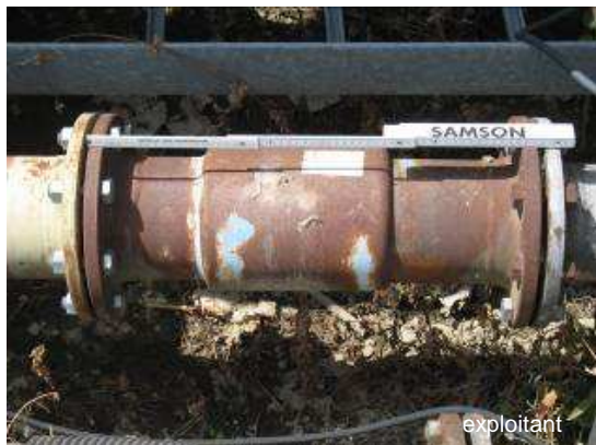
Compensateur de dilatation avant l'accident
