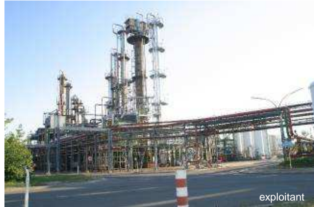
Installations de production et rack de tuyauteries
