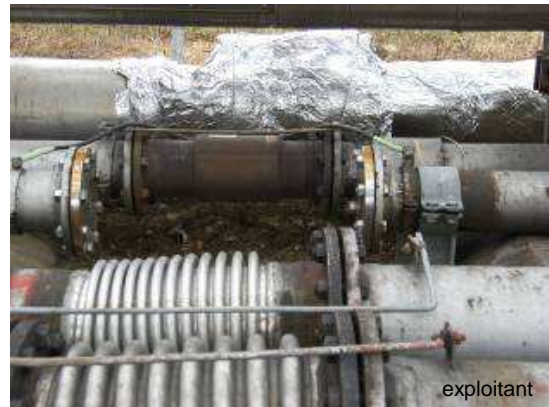
Compensateur de dilatation démonté après l'accident
