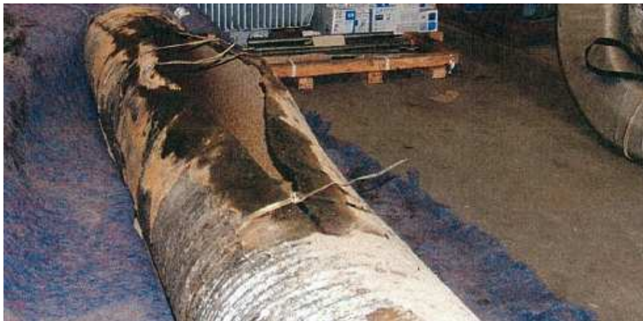
Partie endommagée – DREAL PACA
