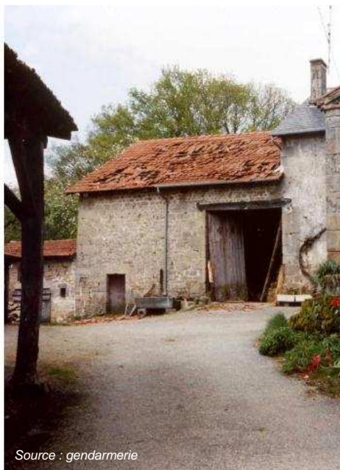
Dégâts au village de Chabannes (situé entre 400 et 600 m - zone Z4)
