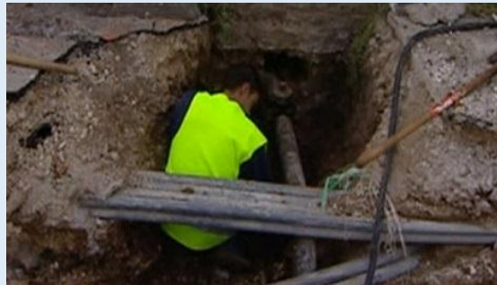
Accident de Dijon (ARIA 21551), un immeuble de 4 étages est soufflé à la suite d'une fuite de gaz naturel sur une canalisation de distribution en fonte grise. 11 morts et 3 blessés sont à déplorer.
