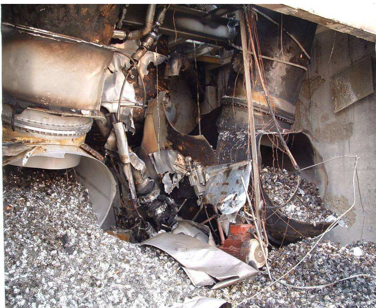
Colonnes endommagées remplies de catalyseur.
