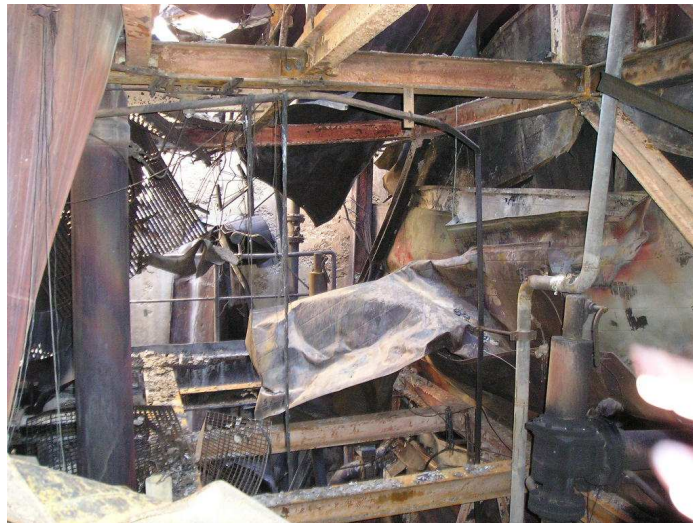
La « chambre froide » détruite
