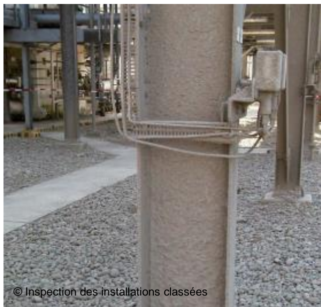
Etat des installations après l'accident
